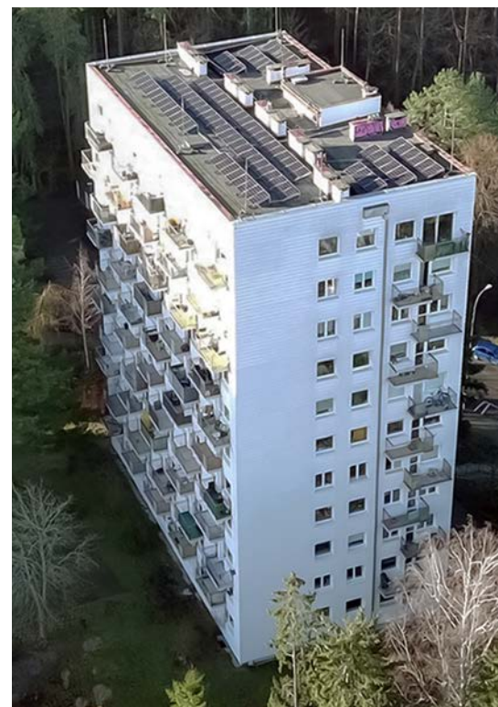
Instalacja fotowoltaiczna na dachu demonstratora w Sopocie
