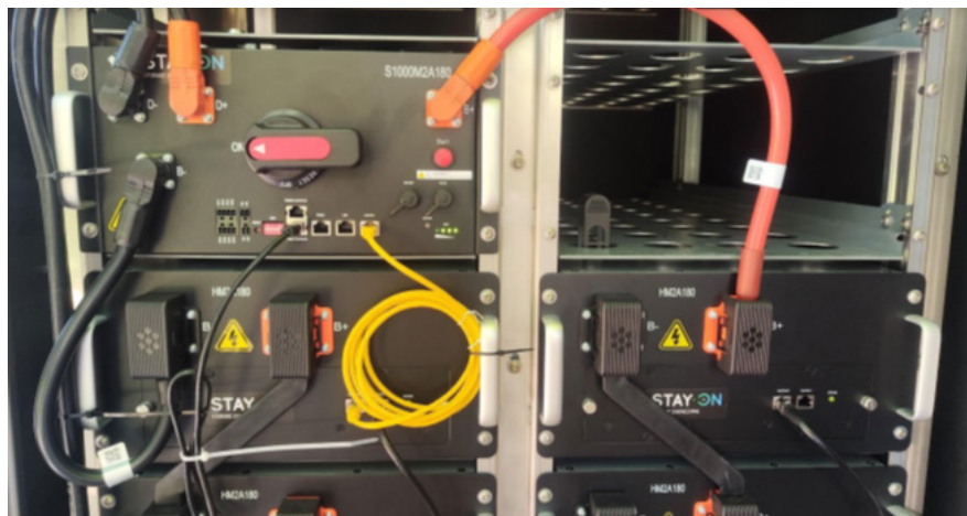
Moduły bateryjne zainstalowane w magazynie energii PFB firmy STAY-ON
