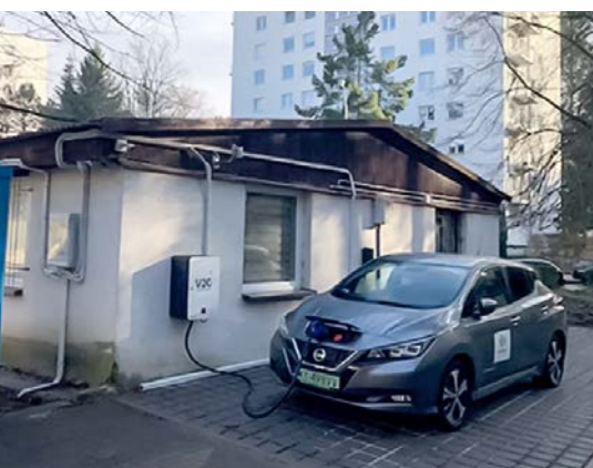
Testy procesu ładowania i rozładowania samochodu elektrycznego w warunkach rzeczywistych przy wykorzystaniu ładowarek z technologią V2G (Vehicle to Grid). Na zdjęciu widoczny magazyn energii STAY-ON, ładowarka dwukierunkowa DC i jednokierunkowa AC oraz samochód elektryczny podczas testów na dedykowanym miejscu parkingowym
