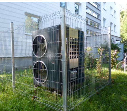
Pompa ciepła powietrze-woda GSJ zainstalowana przy analizowanym budynku demonstracyjnym
