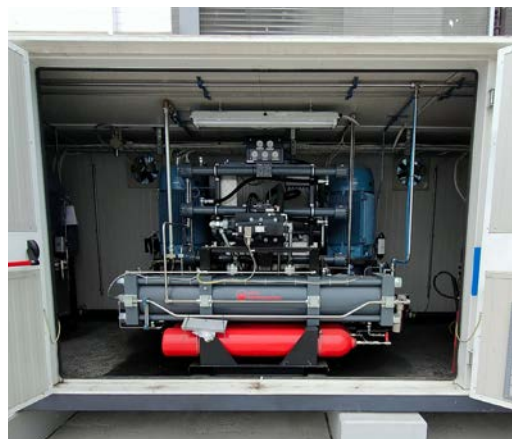
Wnętrze kontenera z zespołem sprężarek
