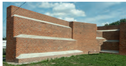
Wrota powodziowe na Kanale Panińskim we wsi Marzęcino pochodzą z 1884 r., przestały spełniać swoją funkcję w okresie międzywojennym – po osuszeniu znajdującego się na północ od nich polderu
