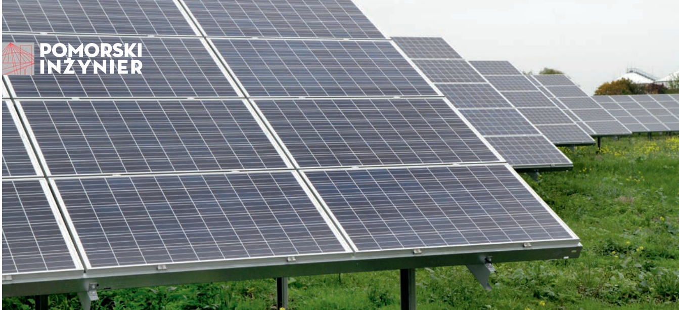
Elektrownia fotowoltaiczna o mocy 1,64 MW wybudowana 10 lat temu na granicy Gdańska i Przejazdowa przez Grupę Energa. Inwestycja została dofinansowana przez Wojewódzki Fundusz Ochrony Środowiska i Gospodarki Wodnej w Gdańsku Fot. Sławomir Lewandowski
