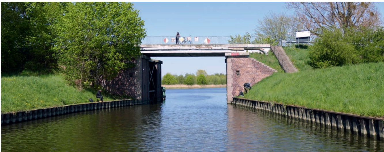
Wrota powodziowe w Bielniku na wyjściu Kanału Jagiellońskiego z Nogatą.
