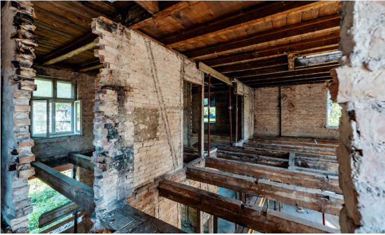
Widok na stan zachowania historycznych belek stropowych
