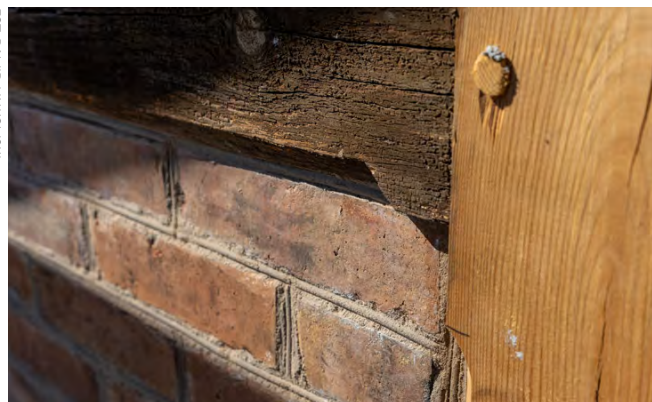
Zdjęcia przedstawiają renowację i rekonstrukcję elementów ścian kolankowych wraz z odtworzeniem konstrukcji ryglowej. Powtórzenie dawnej technologii prac przez cieśle
